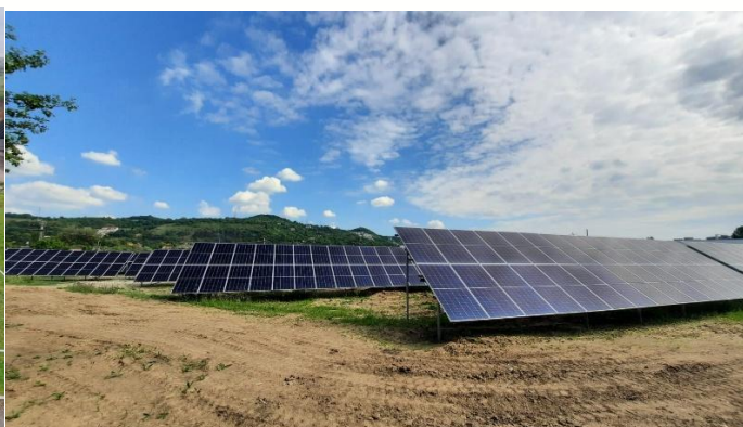
Panouri fotovoltaice Sursa Florești
