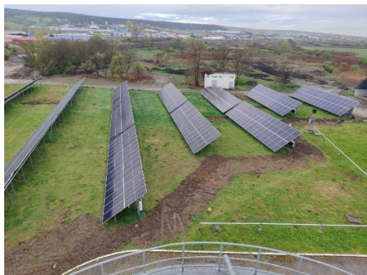
Panouri fotovoltaice Stația de Epurare Zalău
